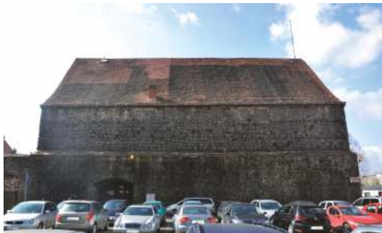
Fot. 2. Elewacja zachodnia Domu Solnego w Lubaniu, stan obiektu przed rozpoczęciem prac konserwatorskich i restauratorskich. Fot. P. Prośniak
